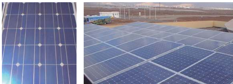
Figura 23. Panel fotovoltaico monocristalino y planta fotovoltaica instalada en cubierta.
